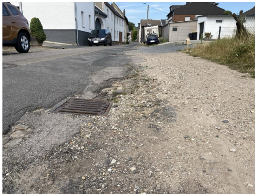
Nicht vorhandener Gehweg und kaputte Straße in der Scherbstraße
